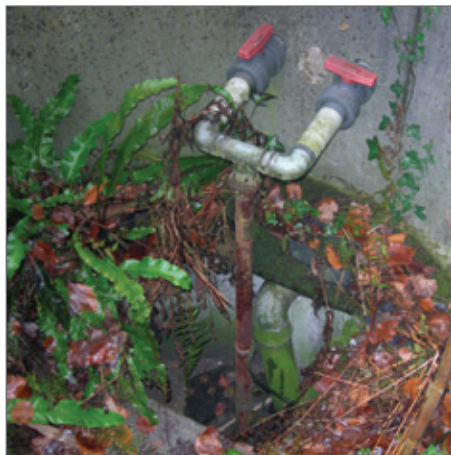
Een kraan laat toe het water te verdelen over rietveld A en B.
