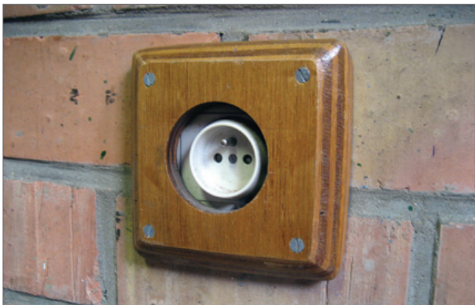
Een houten bakje beschermt het stopcontact.
