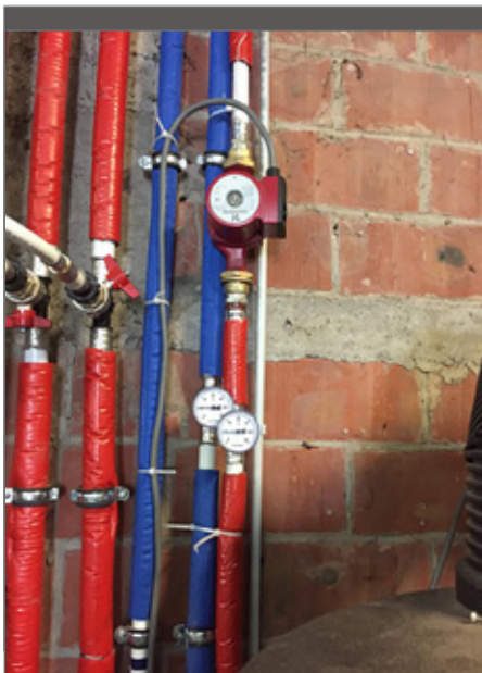
Onze leidingen zijn goed geïsoleerd.
