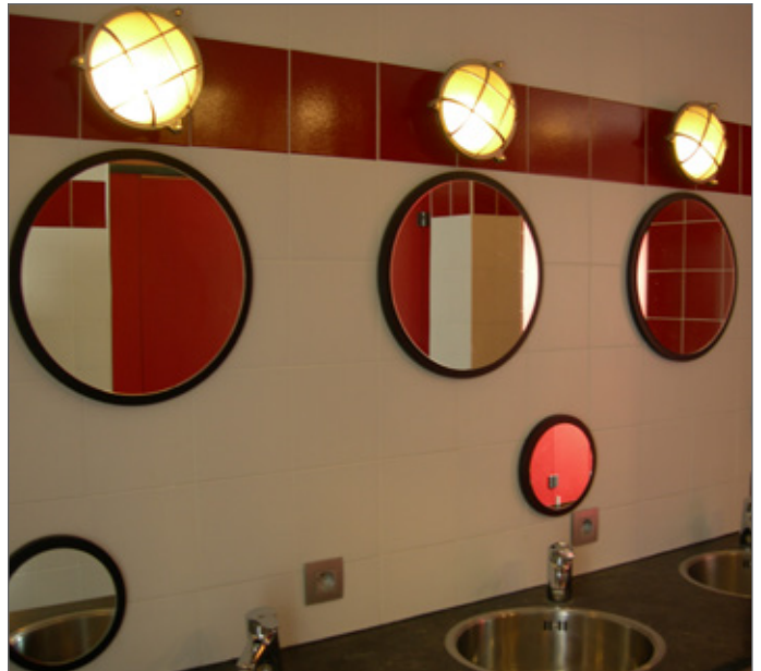
Goede armaturen vermijden hinderlijke weerkaatsing of verblinding.
