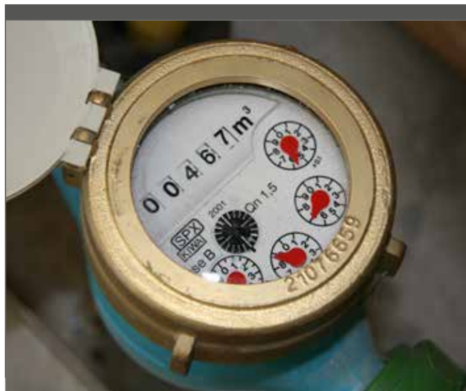
Water- en energieprijzen kunnen op verschillende manieren in de overeenkomst worden opgenomen.
